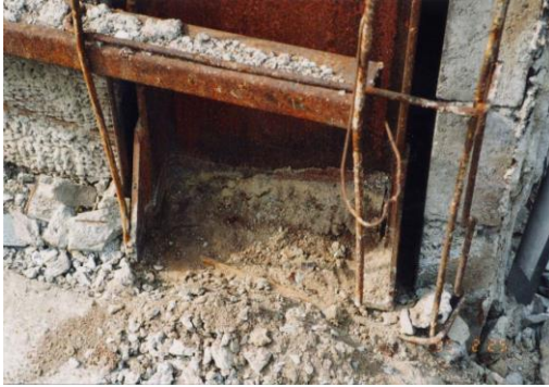
写真 3-10 柱と胴縁の腐食 (C ランク)
