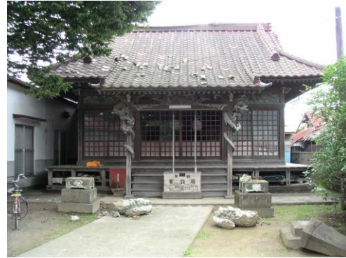
写真 2-15 棟瓦のズレ、損傷 (C ランク)
