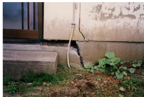
写真 2-8 基礎の破断 (C ランク)
