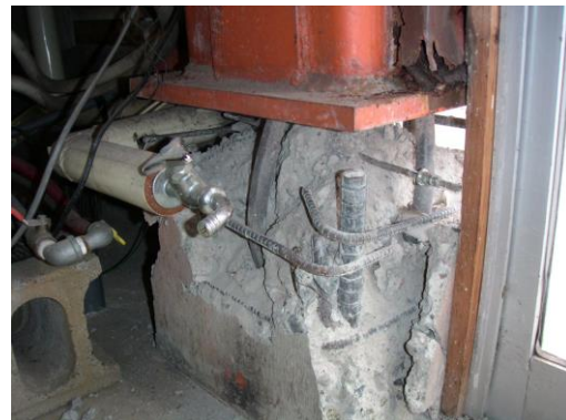
写真 3-2 基礎の著しい破損
