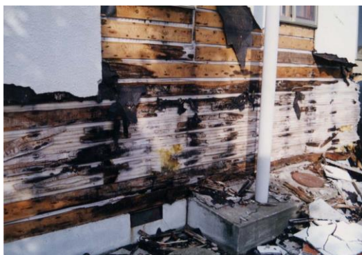
写真 2-12 下地材の腐朽 (B ランク)
