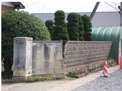
写真 2-24 ブロック塀の転倒危険 (C ランク)
