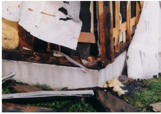
写真 2-13 土台、柱の腐朽 (C ランク)
