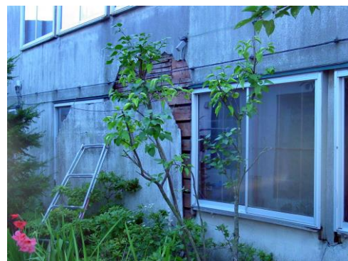
写真 2-19 モルタル壁の剥落 (B ランク)
