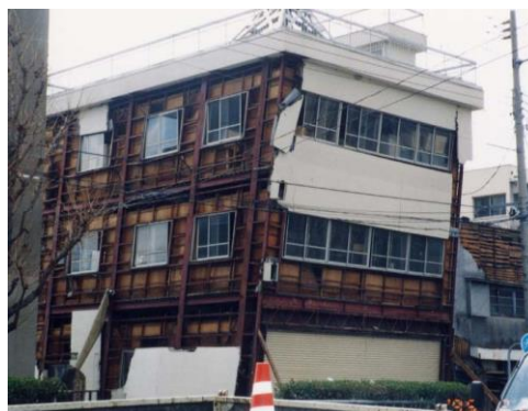
写真3-3 傾斜による外装材の剥落
