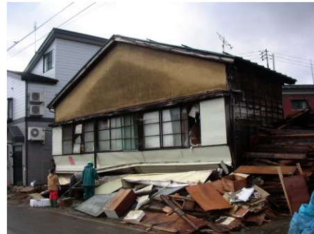
写真 2-2 低層階の崩壊
