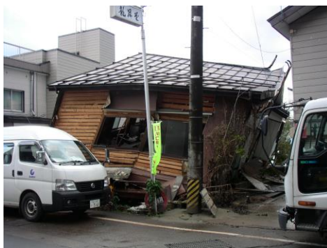
写真 2-3 隣接する建物の傾斜(Cランク)
