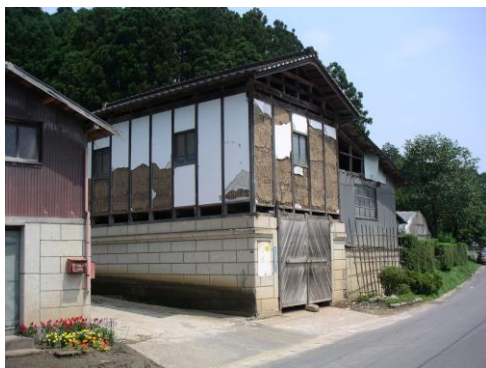
写真 2-18 土壁の剥落 (C ランク)
