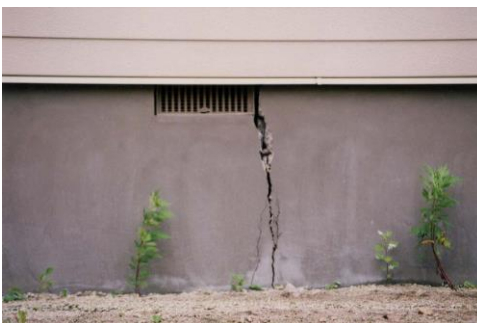
写真 2-7 基礎の亀裂 (B ランク)
