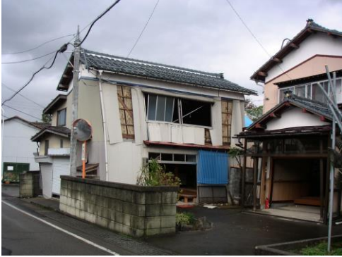
写真 2-20 サイディングの落下 (C ランク)
