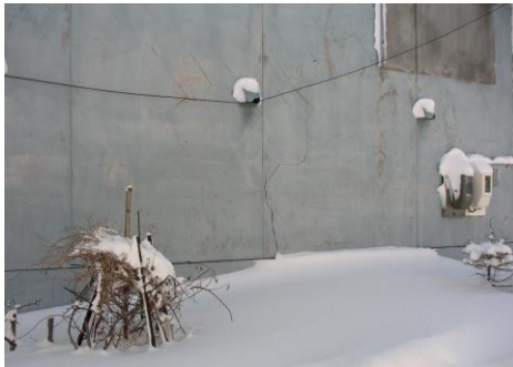
写真3 積雪により基礎被害の確認が困難
