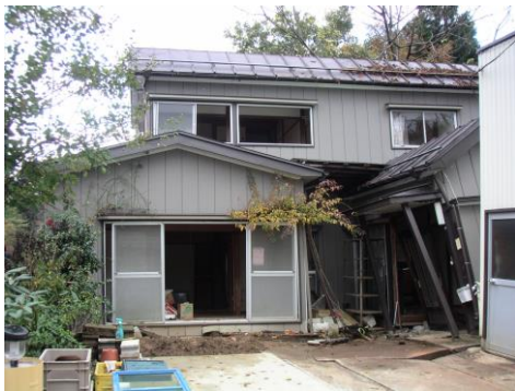
写真 2-16 窓枠の歪み (B ランク)
