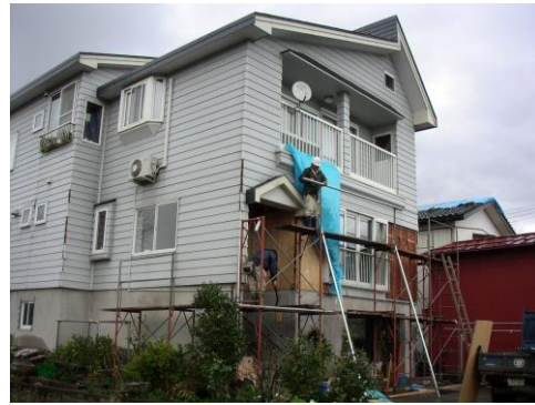
写真 2-21 サイディングの損傷 (B ランク)
