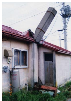
写真 2-25 煙突の転倒危険 (C ランク)
