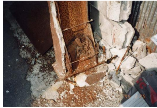
写真 3-11 柱脚の腐食 (C ランク)
