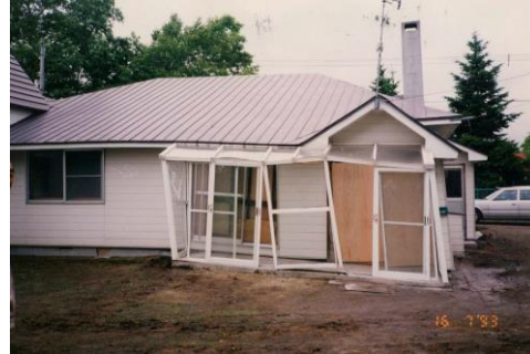
写真 2-6 建物の不同沈下 (C ランク)
