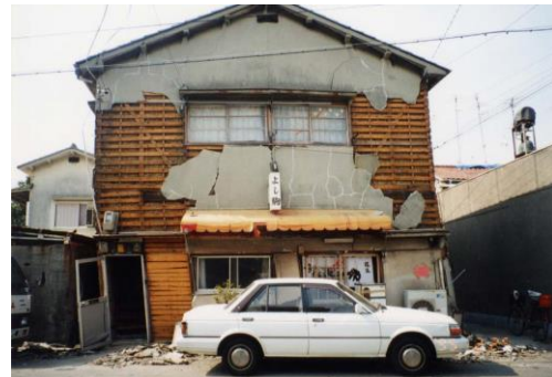
写真 2-11 外壁の被害 (C ランク)
