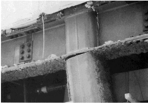
写真 3-6 柱頭での柱溶接部の破断
