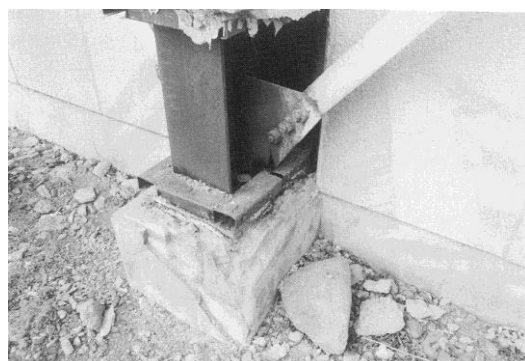
写真 3-9 柱脚コンクリートの部分破壊
