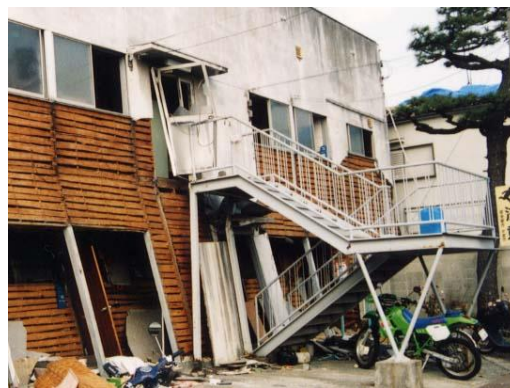
写真 2-23 屋外階段の傾斜被害 (C ランク)
