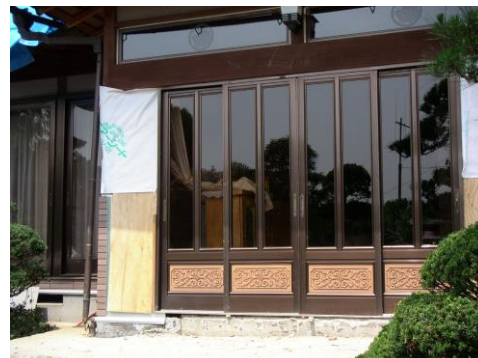
写真 2-17 玄関戸の歪み (B ランク)
