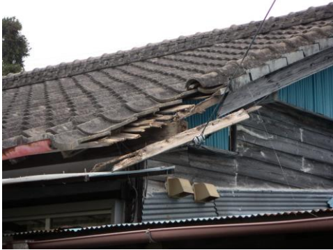
写真 2-14 屋根瓦の落下損傷 (B ランク)
