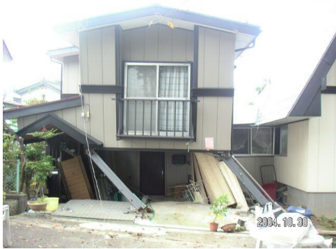
写真 3-1 著しい構造的被害
