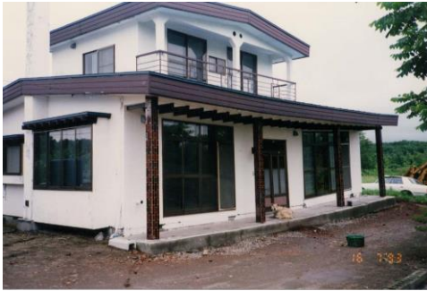
写真 2-5 建物の不同沈下 (B ランク)
