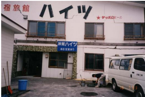
写真 2-10 外壁の被害 (B ランク)
