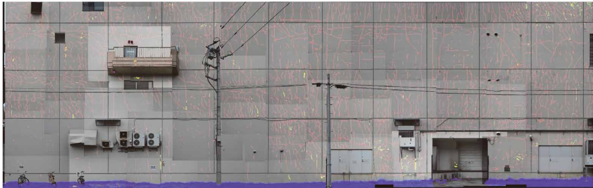
図6 調査対象の外壁劣化検出例
