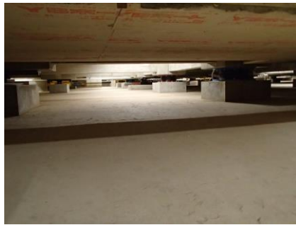
免震構造積層ゴム
